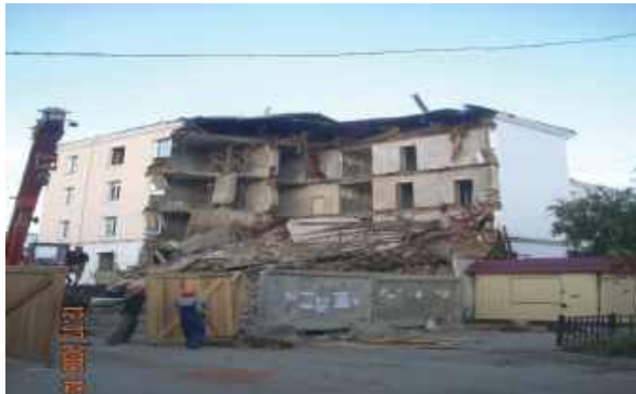
Рис. 7. Разрушение здания в г. Якутске за счет нарушения мерзлотных условий грунтов основания. Фото С.И. Серикова
